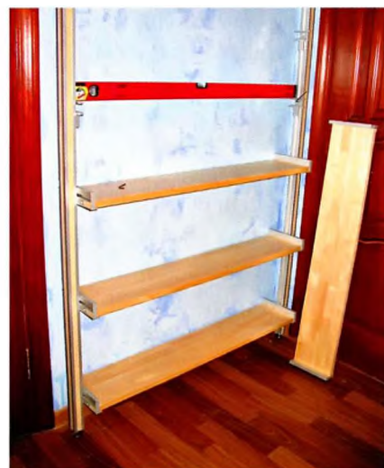
Установка промежуточных полок: сначала крепёжные пластины и уже к ним — полки. Полки можно устанавливать не только на планки, но и на зажимы. В конструкции использованы оба узла.
